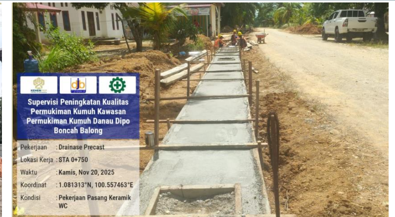
Cor Cover U Ditch STA 0+750
