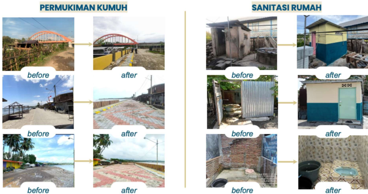
Gambar III.6 Pelaksanaan Fisik Kegiatan Peningkatan Kualitas Kawasan Kumuh dan Sanitasi Rumah Kawasan Pantai Jempol, Kab. Sumbawa Tahun 2025
