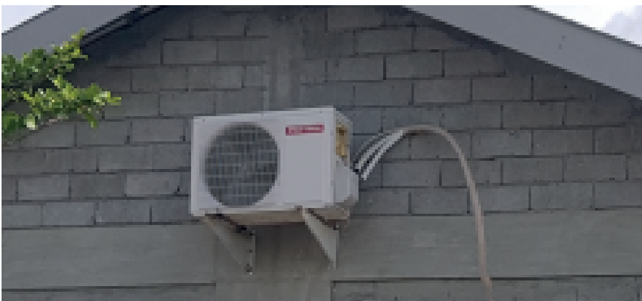
Peletakan AC yang tidak tepat
