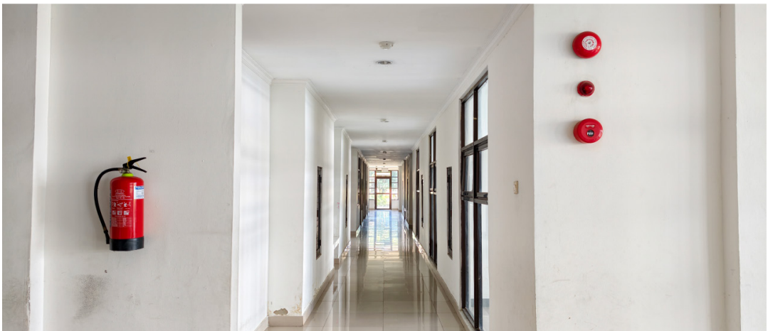
(Rusunawa Rancaekek dilengkapi alat pemadam kebakaran yang terpasang di dinding koridor)
