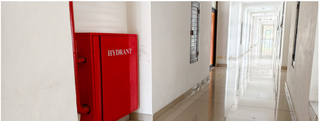
(Rusunawa Rancaekek dilengkapi alat pemadam kebakaran yang terpasang di dinding koridor)
